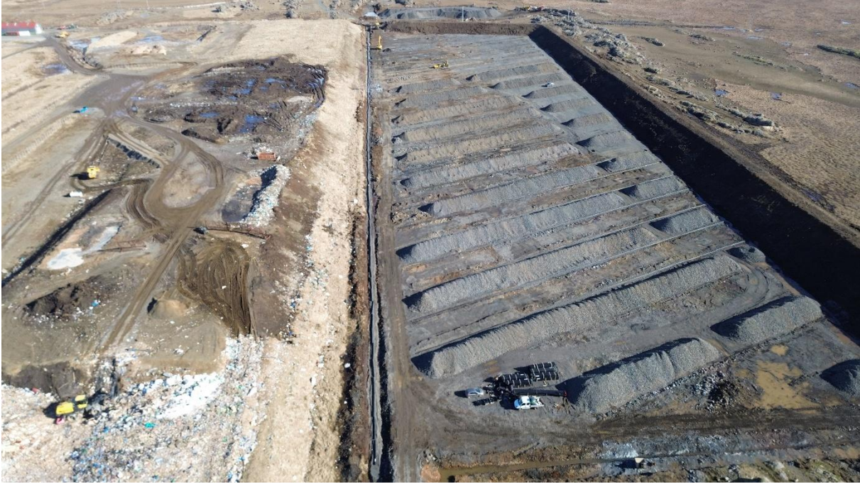
Mynd 2. Loftmynd af urðunarrein nr. 5 tekin 2. apríl 2025, (horft til norðurs). Frágangur lagna og drenmalar í botni reinarinnar í undirbúningi. Urðunarrein nr. 4 er vinstra megin á myndinni og unnið að urðun syðst í henni. Efst til vinstri sjást aðstöðuhúsin í Fíflholtum. (Ljós. EFLA verkfræðistofa).
